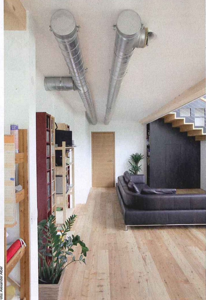
Zentraler Wohnraum mit Küche: Die Installationsrohre bleiben bewusst sichtbar
